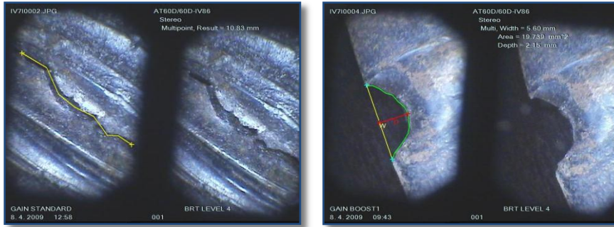
Obr. č. 7 a 8 : Ukážka merania zložitej trhliny a šírky, hĺbky a celkovej plochy vrubu na hrane pomocou stereoskopického merania videoendoskopom
